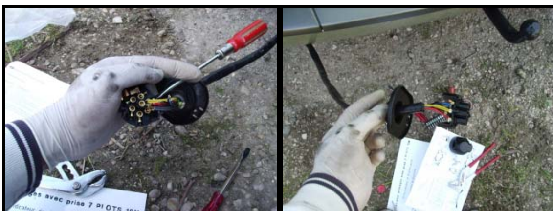
Figure 47 : Photos de la connexion des câbles à la prise de l'attelage.
